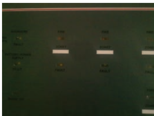
شکل ۱-۳۳ لامپ های قرارداده شده در داخل تابلو
