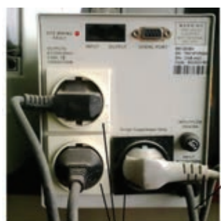
پریز های برق خروجی
