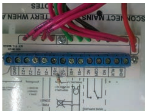
شکل ۱-۳۱ ترمینال های اتصال
